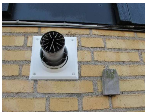
Udluftning / aftræk fra gasfyr
