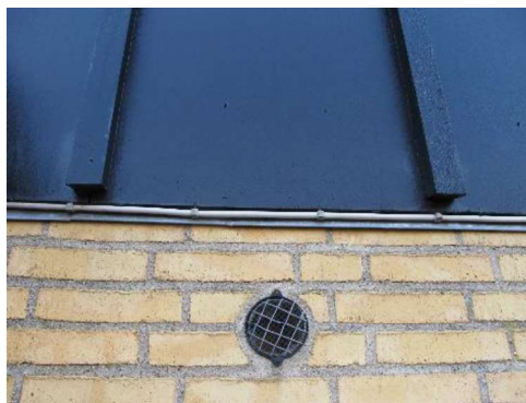
Udluftning fra emhætte
